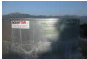
Μια από τις σύγχρονες υδατοδεξαμενές που έχουν τοποθετηθεί σε επίκαιρα σημεία για τις ανάγκες πυρόσβεσης.
